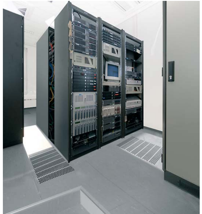
Umzug in den neuen EMPIC-Rechnerraum: Die Klimaanlage wurde nach neuesten Wirtschaftlichkeitsaspekten konzipiert.
